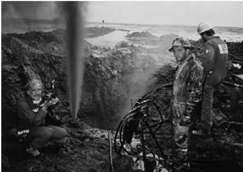
Tareas de extinción y sellado de los pozos petroleros tras la liberación en 1991. Gustavo Ferrari junto a un equipo de técnicos franceses.
